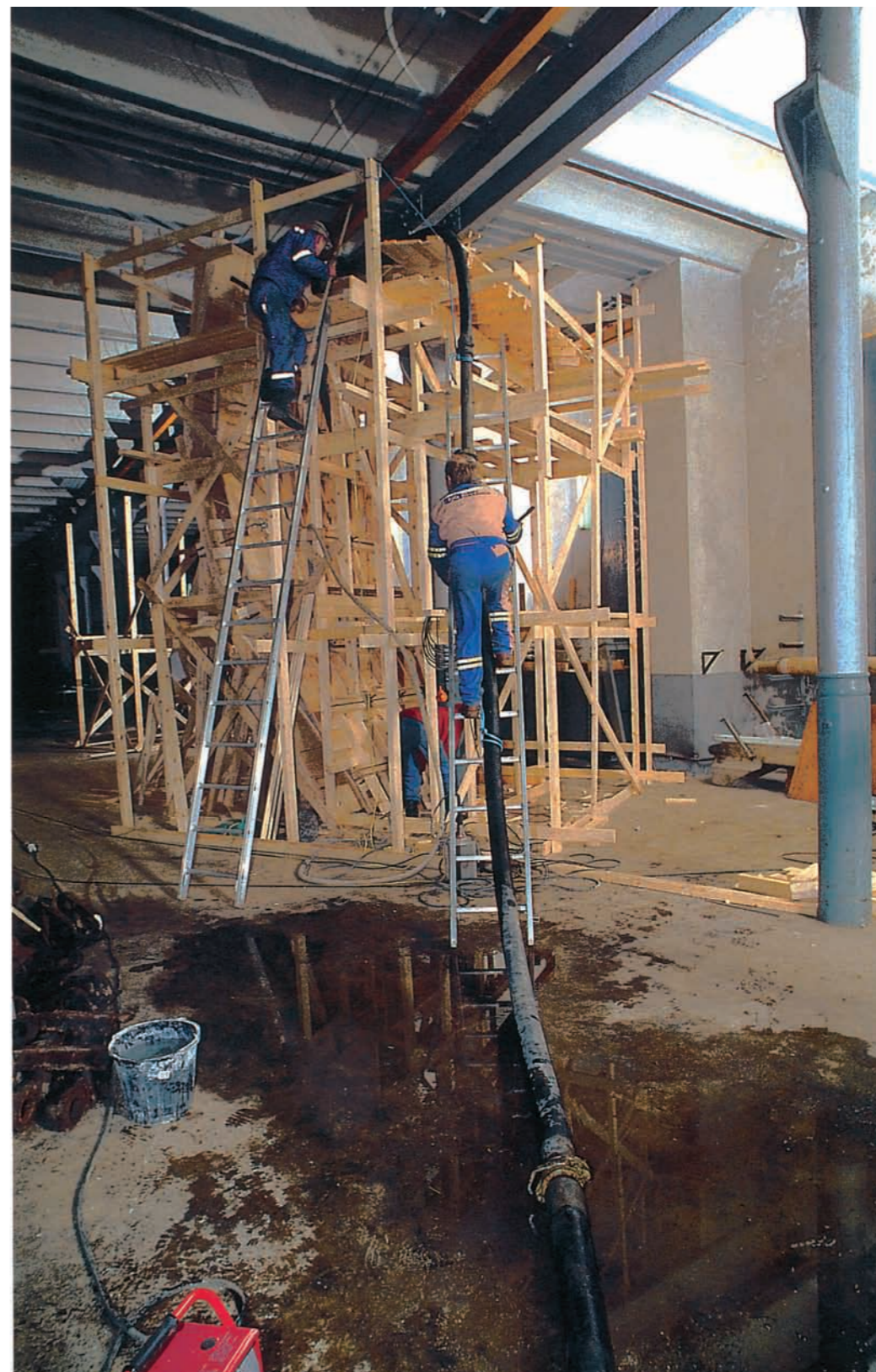
En svær, tjukk slange strekkes inn i rommet. Den heises opp til hullet i forskalingen ved hjelp av tau og mannskraft.
